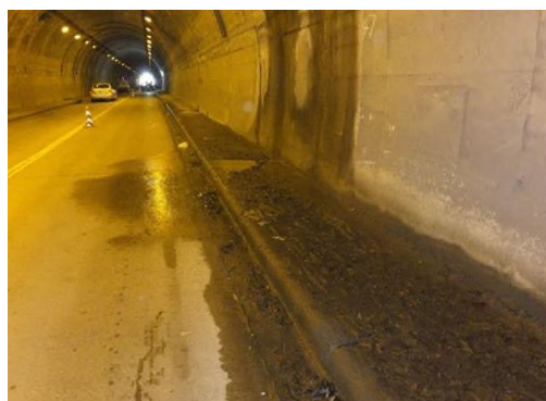
漏水の例 (2) 路面に滞水
