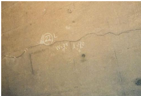
ひび割れの例
