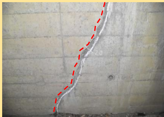
③コンクリートの材質劣化で発生した「ひび割れ」。幅 1mm 以上のものは監視する。
