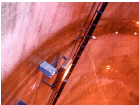
漏水の例 (1) 天井から吹き出し
