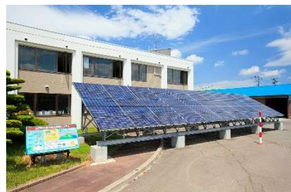
太陽光発電設備（七戸町本庁舎）
