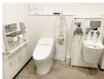
多機能な設備を配備したトイレの事例
