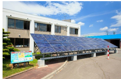
太陽光発電設備（七戸町本庁舎）
