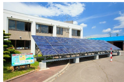
太陽光発電設備（七戸町本庁舎）
