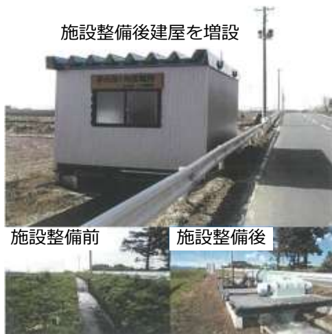
早川1号発電所(七戸町早川幹線用水路)
